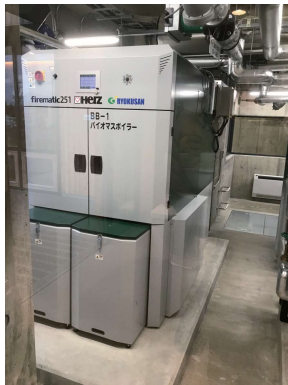
北の森づくり専門学院 バイオマスボイラー
